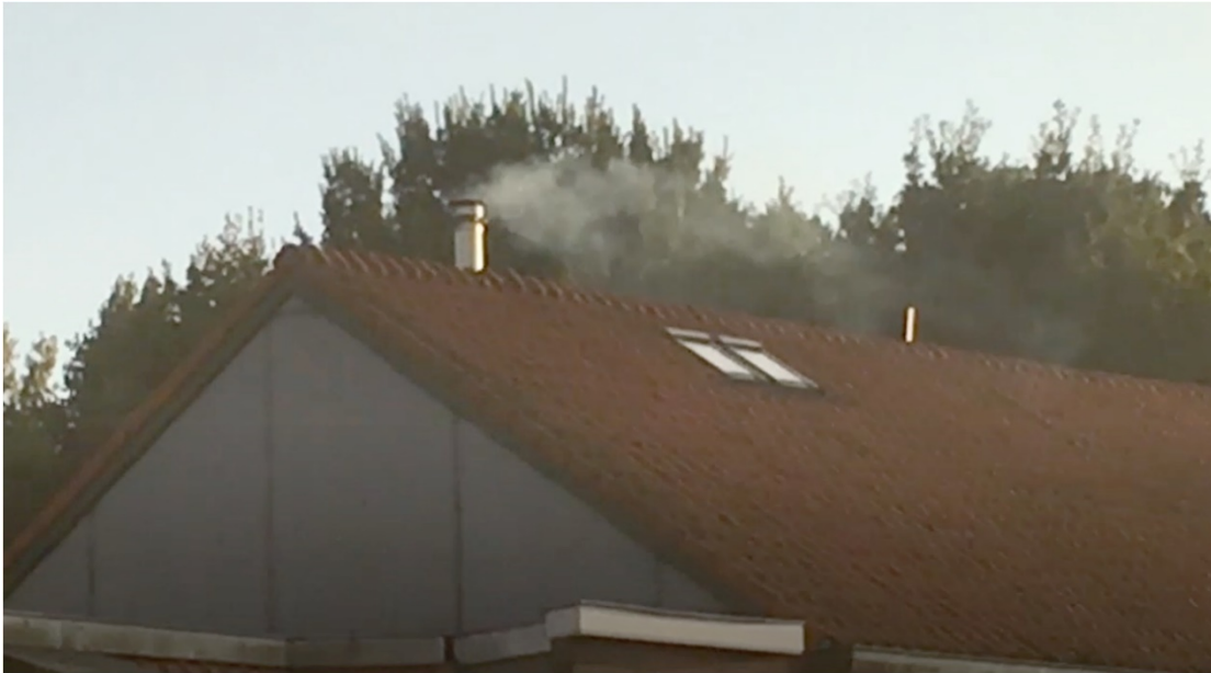
Afbeelding 8.14: Pluimasverlaging bij afvoer boven nokhoogte (foto STAB)
