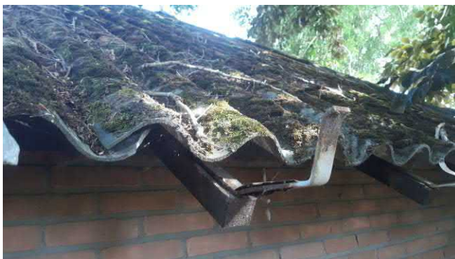
Afbeelding 2.3: Asbestverdacht dak zonder dakgoot
