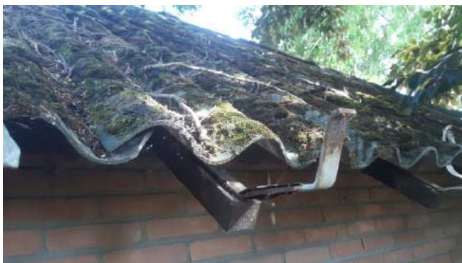
Afbeelding 2.3: Asbestverdacht dak zonder dakgoot
