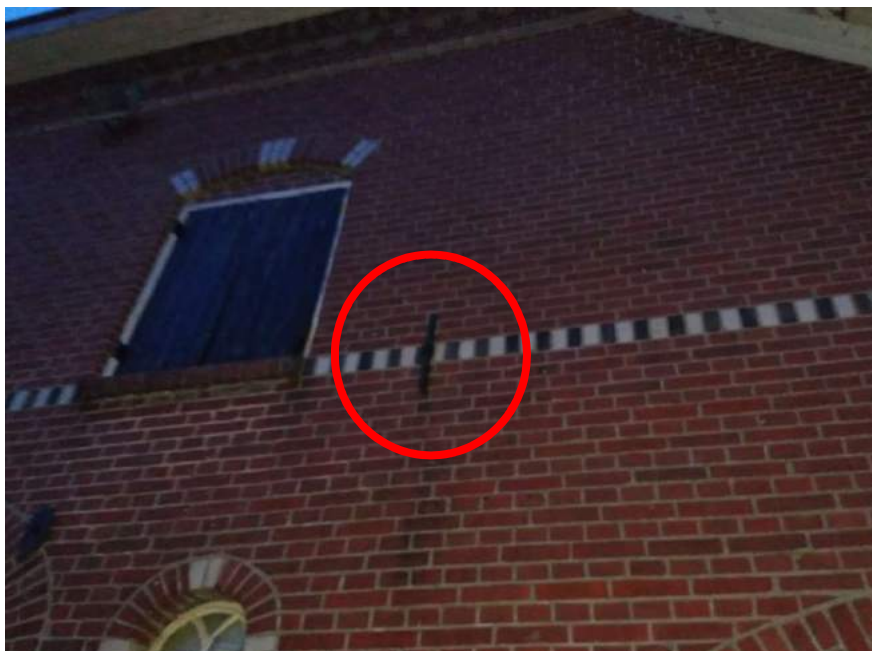
Afbeelding 6. Verblijfplaats van gewone dwergvleermuis in een holte in de muur bij het muuranker.
