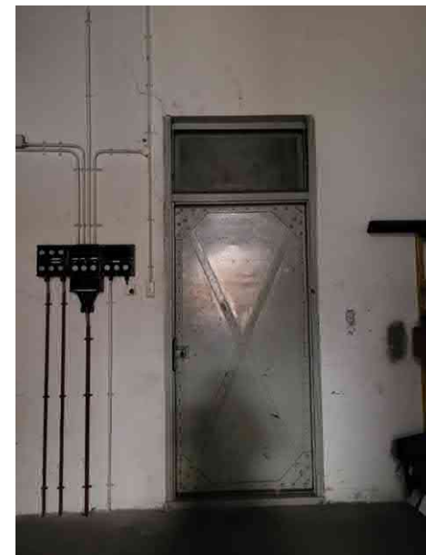
Een deur in het schakelhuis
