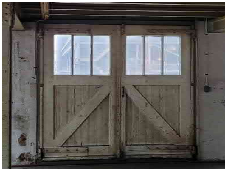
Een van de hijsdeuren in 45E
