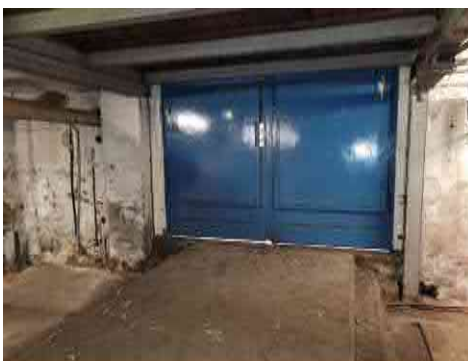
De constructie achter de toegangsdeur is te demonteren zodat de machines gemakkelijk vervangen konden worden
