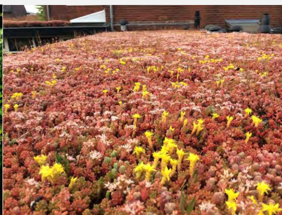
afbeelding 12: Sedumdak in bloei. Foto: Marco Lode
