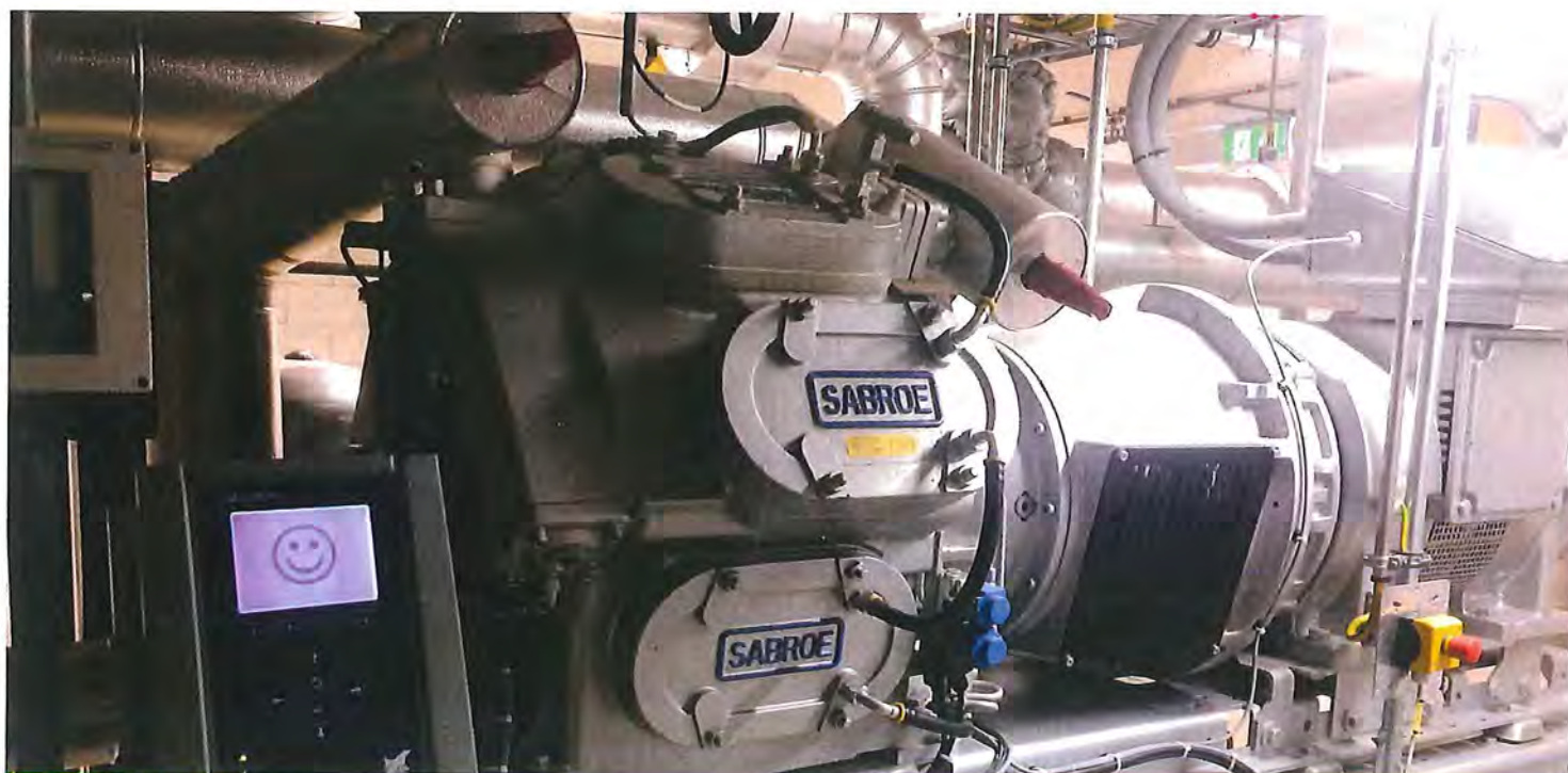
De warmtepomp van Ennatuurlijk (foto Lieuwe Leijstra)
