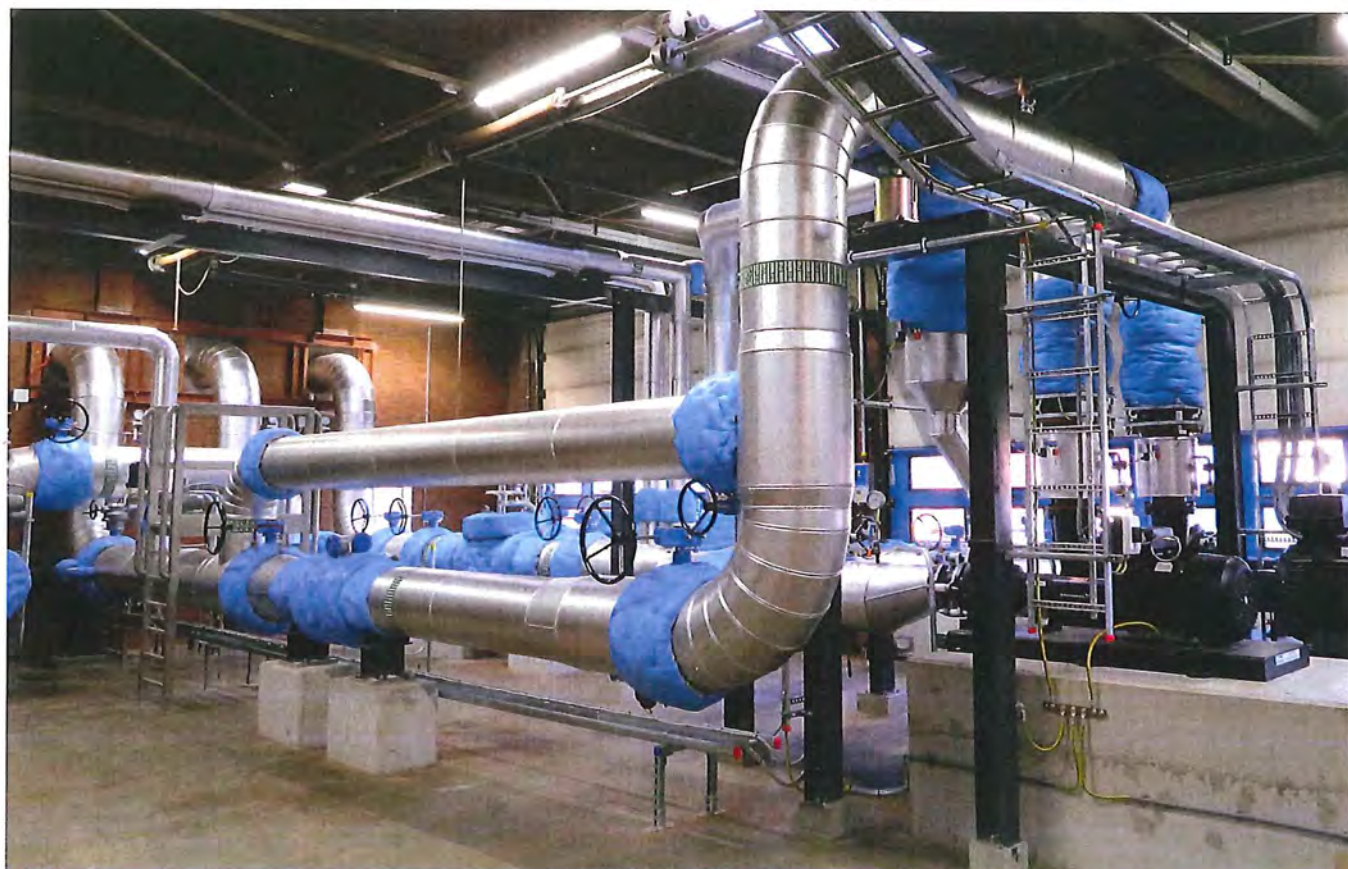
Interieur van het pompstation
