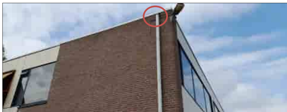
Afbeelding 4.7: Foto van een hoek met daarin een ruimte om de spouw te bereiken (rood omcirkeld).
