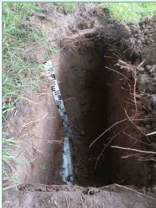
Foto 2 Aangetroffen beworteling en mantelbuis
